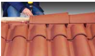
Pose des clips pour fixation des faîtières pureau variable sur lisse de rehausse.
